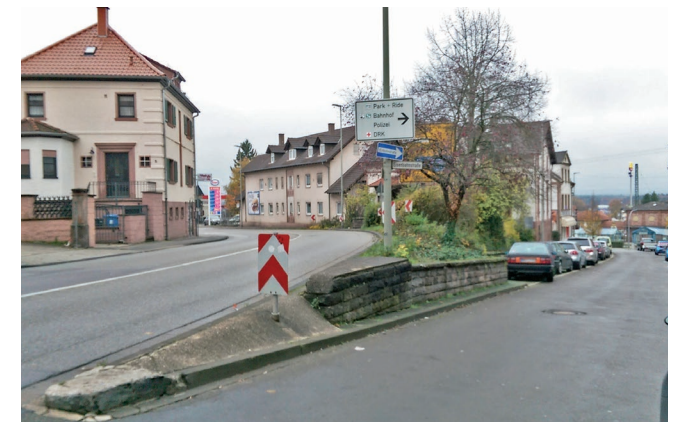
Stützmauer einer Grünfläche in der Eisenbahnstraße
